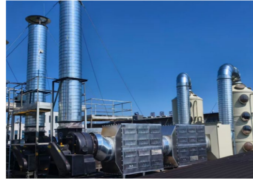
① 废气处理设施
