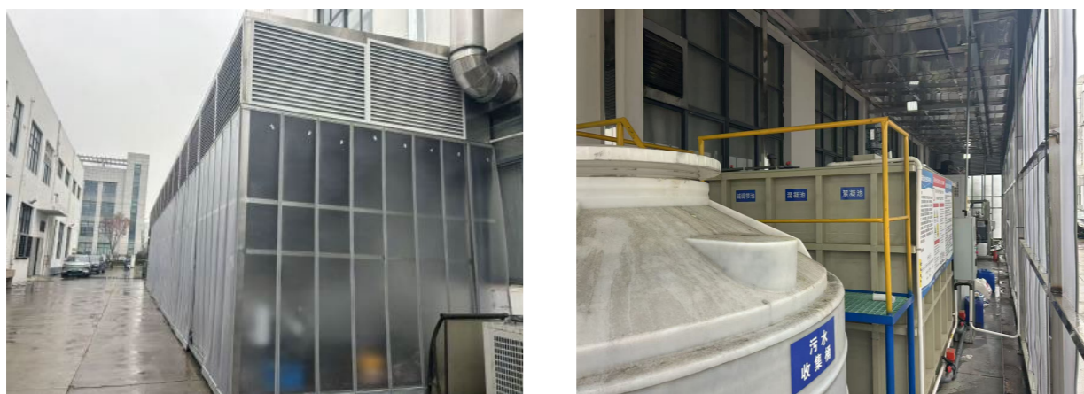
▲ 再生水回收利用设备
