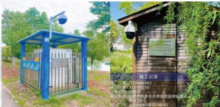
某市地表水自动监测网络建设项目
