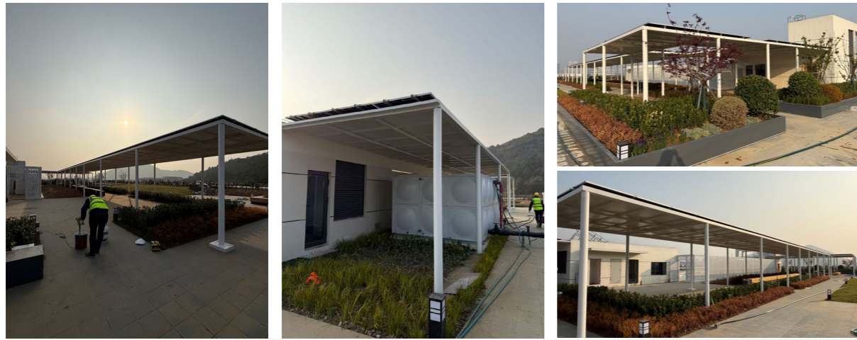
裕太科技中心屋顶分布式光伏
