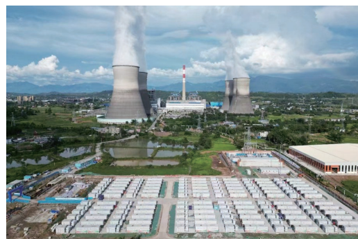
重庆某地 480MWh
