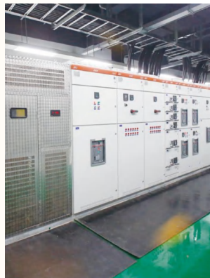
智能化、高效配电 及高频 UPS
