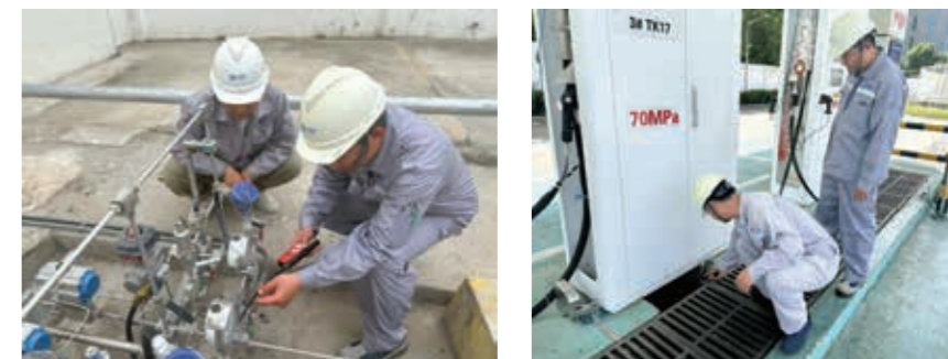
安全隐患排查
